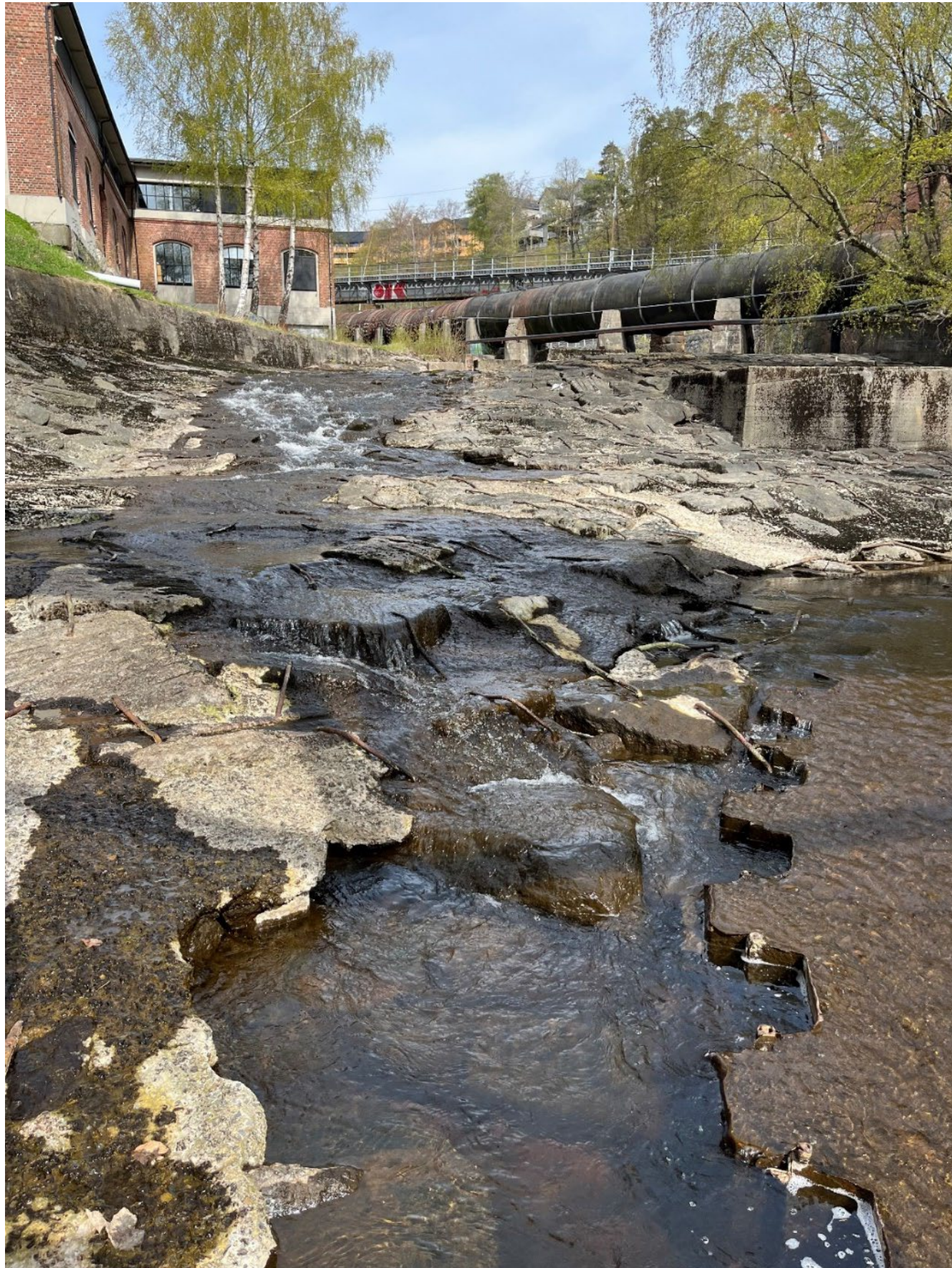
Figur 17 Lite fossefall nede mot utløpskulverten fra kraftverket. Dekket i fossefallet består av stein og betong og er stedvis lekk slik at vann forsvinner fra overflatestrømmen. Vannføringen den 10.05.2023 som var ca 80 l/s kan ses i øvre del av dette lille fossepartiet.
